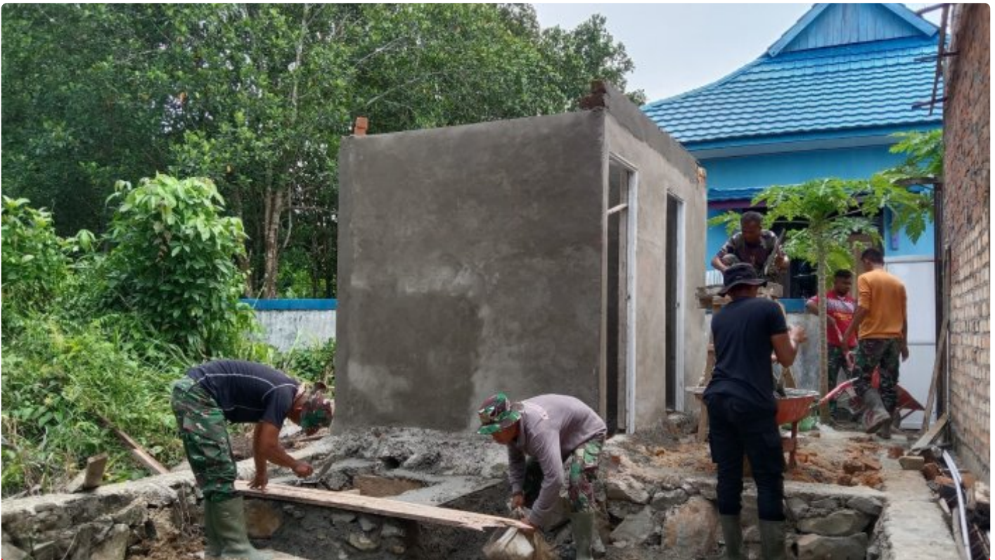
Satgas TMMD ke- 118 Wiltas Kodim 0910/Malinau Progres Pembuatan Septic tank MCK Gereja
